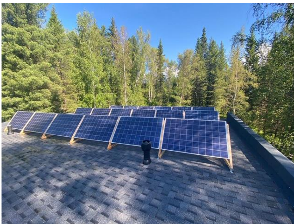
Рисунок 1 Солнечные батареи смонтированы на крыше жилого блока
